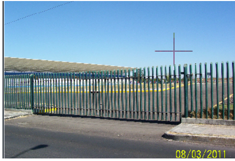
El acceso sur del Estadio, se realizó para la obra de construcción y se acordó clausurar. Y habilitar protecciones en su parte inferior para evitar el acceso de personas.
