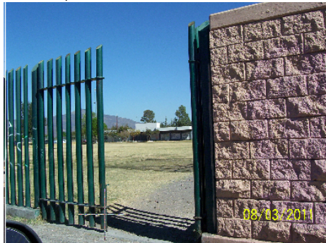
Se clausura y reforzarán las medidas de seguridad en las bardas contiguas para evitar que se salten los usuarios del frontón.
